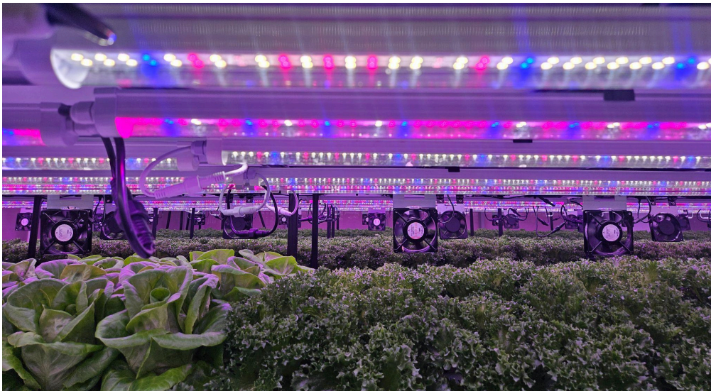
사진 | 재배작물에 최적화된 광원 조합을 개발하여 설치한 LED설비
